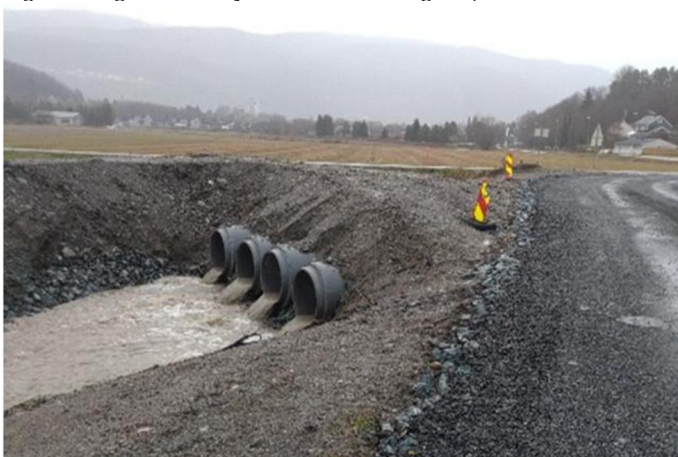
Figur 3 Dagens situasjon for vanngjennomløp av Varmbubekken i Statsråd Nissens vei.
