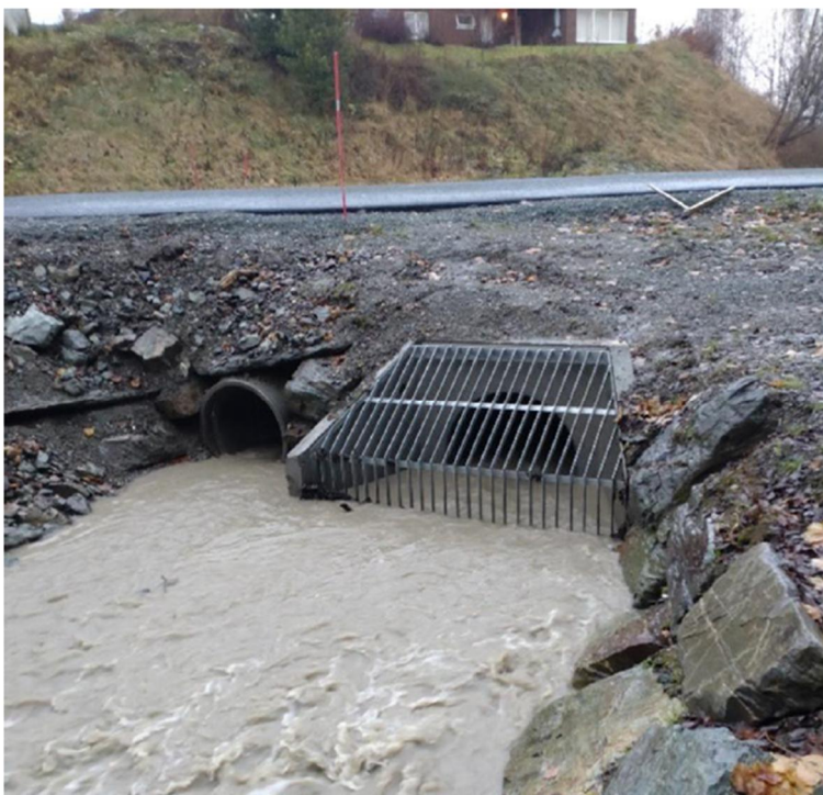
Figur 2 Dagens situasjon med to betongrør på henholdsvis DN800 og DN1200 gjennom Drammensveien.
